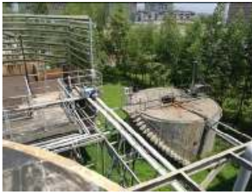
污水处理站（局部）
