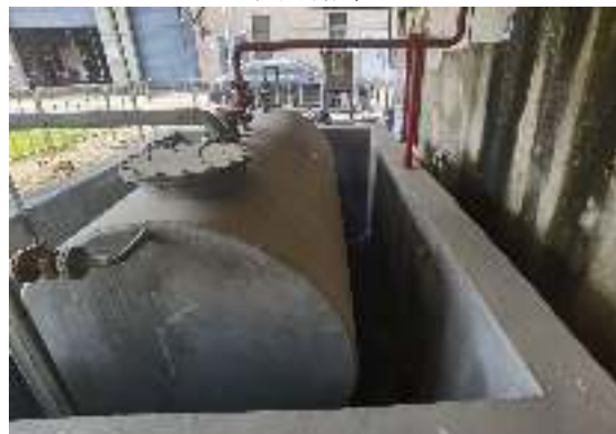
柴油储罐半地下离地
