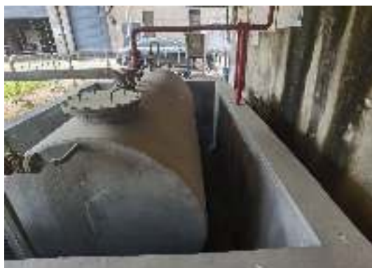
柴油储罐半地下离地
