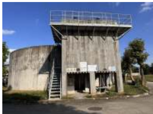
污水处理站（局部）
