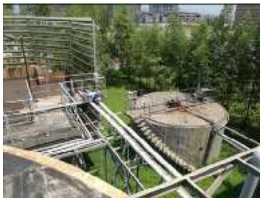
污水处理站（局部）
