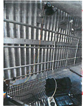
1号炉脱硝A侧出口
