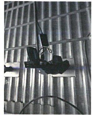
2号炉脱硝B侧出口
