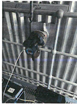
2号炉脱硝A侧出口
