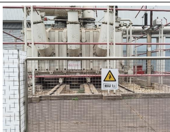
变压器事故排油池
