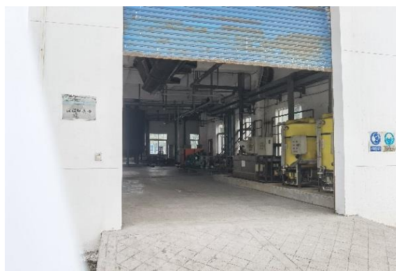
脱硫废水处理
