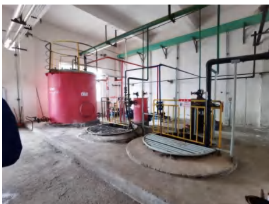
碳酸钠贮槽、盐水配制槽
