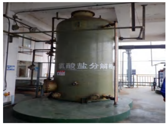
氯酸盐分解槽
