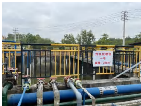
污水处理系统
