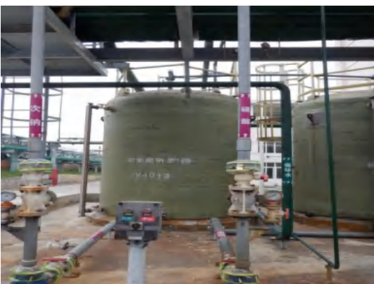
次氯酸钠贮槽
