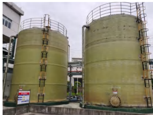
一次盐水及化盐水贮槽
