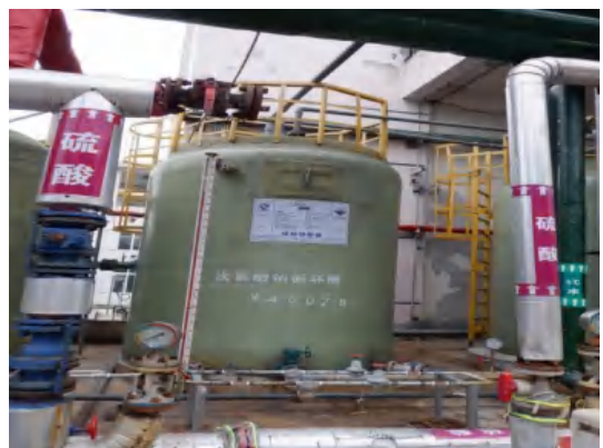
次氯酸钠循环槽
