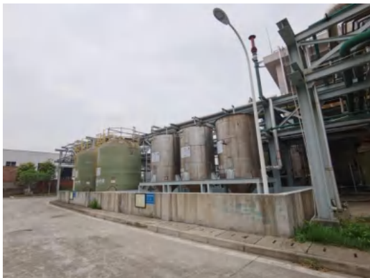
二次盐水制备区
