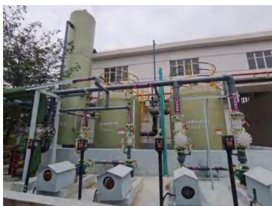
废氯处理塔及次氯酸钠循环槽
