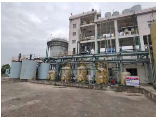
一次盐水制备区
