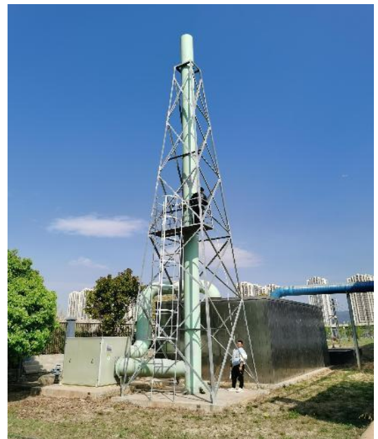
污泥储区生物除臭装置排气筒
