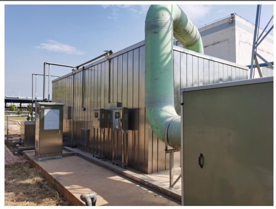
污泥储区生物除臭装置
