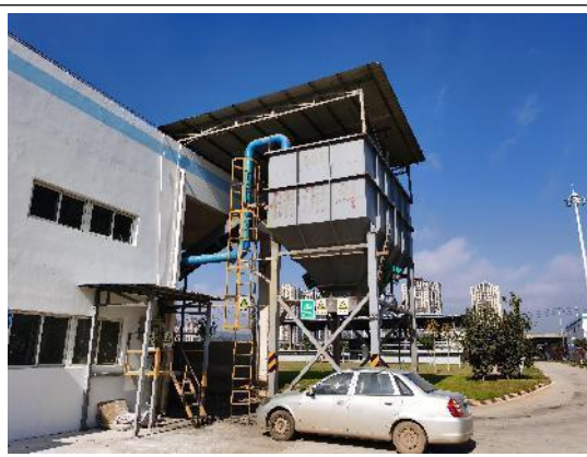
脱水污泥转运区
