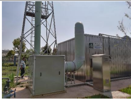
预处理区生物除臭装置
