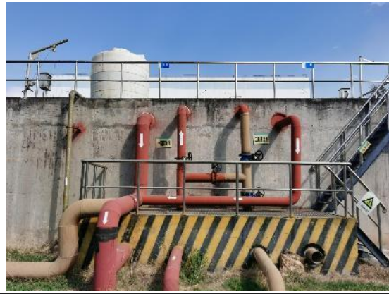
储泥池（两期共用）
