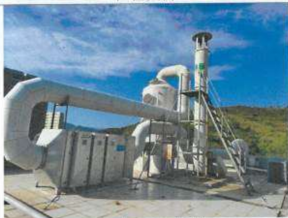
楼顶废气处理设施
