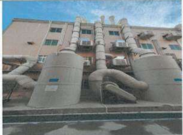
废气处理设施
