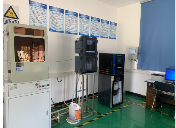
16. 进水在线监测站房内部
