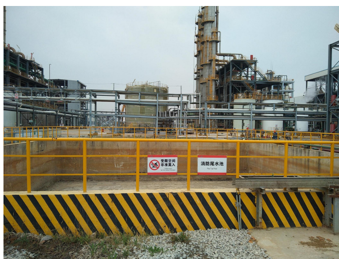
5.1-8 事故池（消防尾水池）
