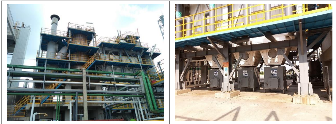
图 4.3-2 焚烧车间现场照片
