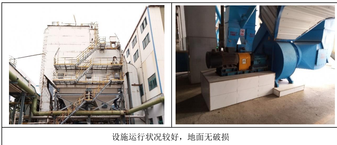
图 5.1-5 导热油炉熔盐炉区
