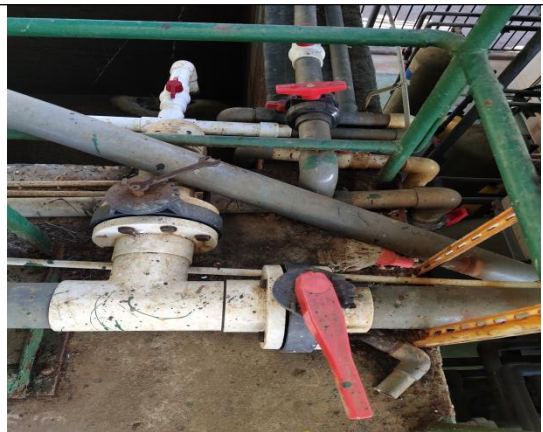
废水管道及连接
