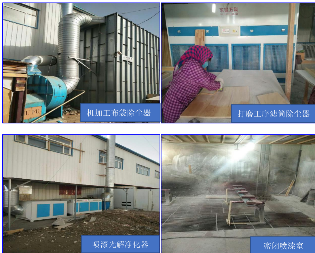
图 3-2 废气治理设施
