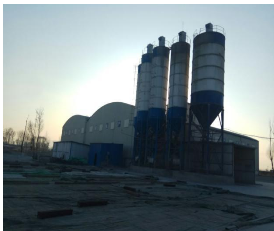
图 3-1 料仓顶部除尘器
