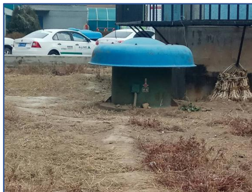
图 3-2 地下车库排风口
