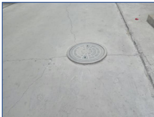
图 3-1 小区内化粪池
