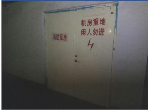
图3-3 小区内消防泵房设备间
