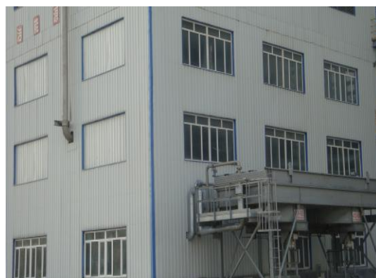
全封闭压缩机厂房 2
