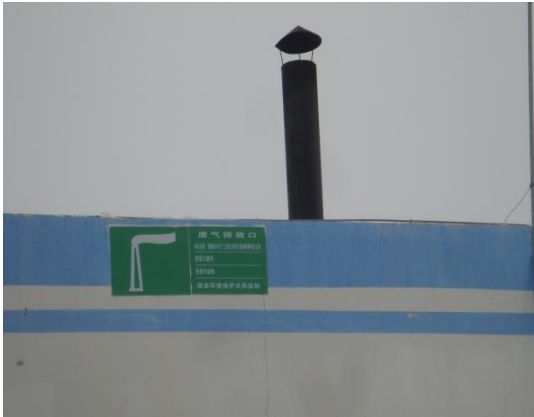
燃气供暖锅炉废气排放口标识标牌
