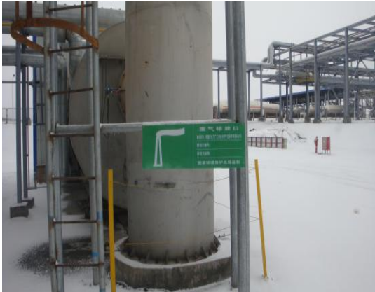
燃气导热油废气排放口标识标牌
