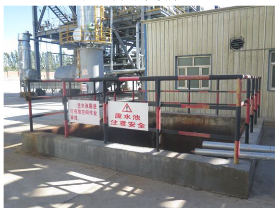
52\text{m}^3 防渗生产废水池
